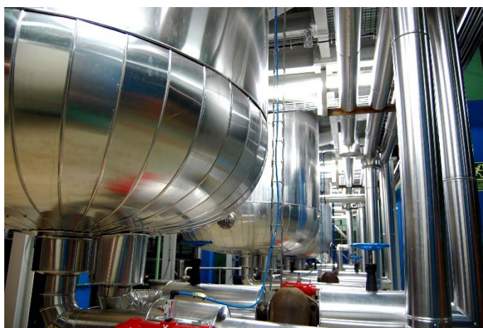
Figura 26: Tratamiento efluentes en zona contenida (Autorizado CISA, Valdeolmos (Madrid))
