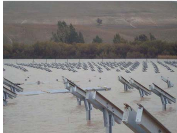
Figura 2: Siniestro por desbordamiento de río (montaje instalación solar fv)
