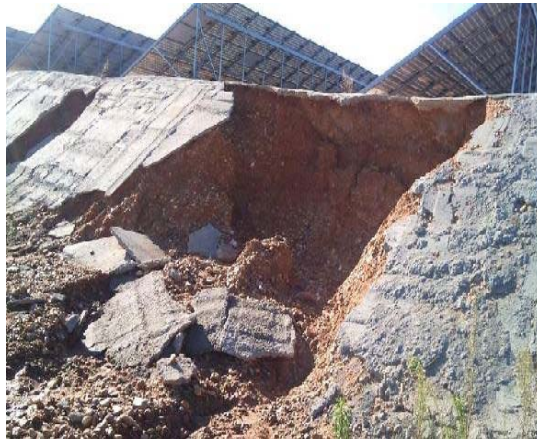
Figura 10: Sinistro por inundación extraordinaria (explotación instalación solar fv)
