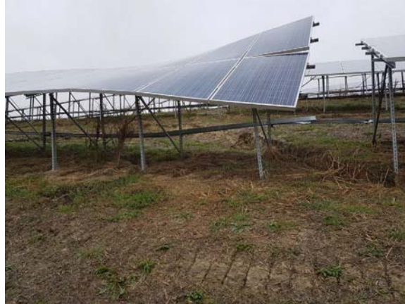
Figura 8: Siniestro por movimientos de terreno (explotación instalación solar fv)
