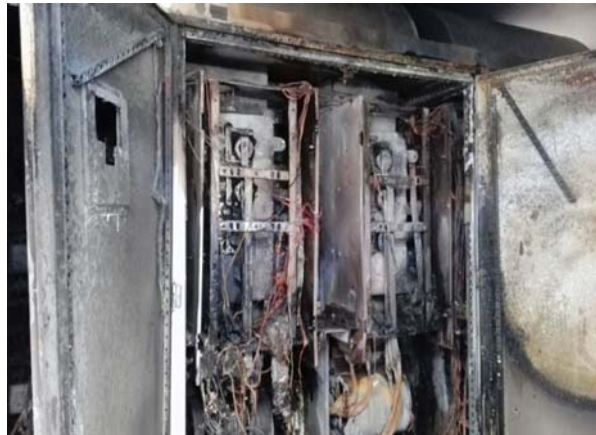
Figura 6: Siniestro por incendio (explotación instalación solar fv)
