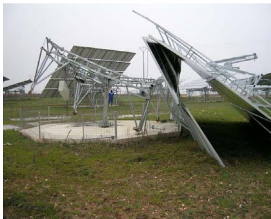
Figura 11: Sinistro por fuertes vientos (explotación instalación solar fv)
