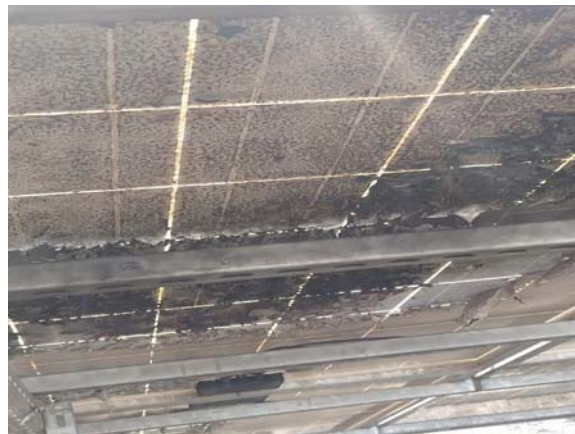
Figura 5: Siniestro por incendio forestal (explotación instalación solar fv)
