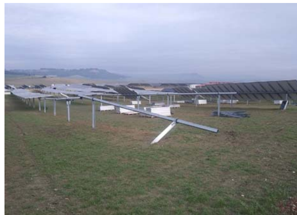
Figura 3: Siniestro por fuerte viento (montaje instalación solar fv)
