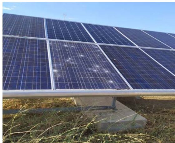
Figura 9: Siniestro por pedrisco (explotación instalación solar fv)
