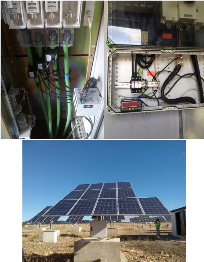
Figura 2.6 – Detalle parcial del sistema de monitorización instalado
